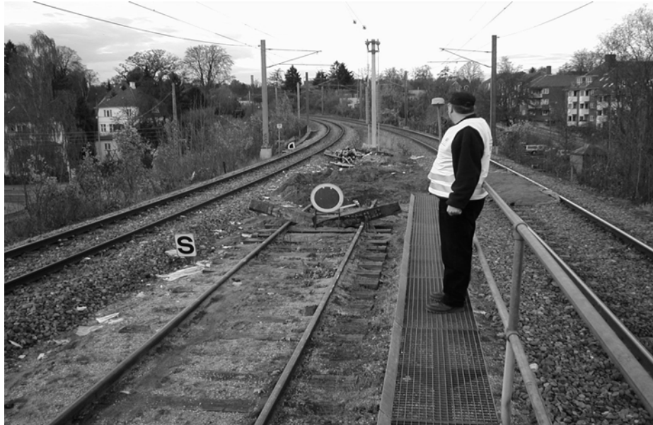
Nordenden af spor 21 dagen efter ulykken, med standsningsmærke til venstre for sporet, standsignal ”stop”. Bag dette anes mærke ”stop” og sporstopperen.
